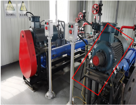
葡浅 6 注汽站机泵减震基础
