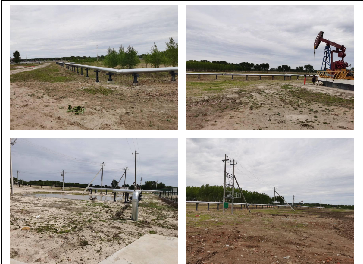
架空注气管道
