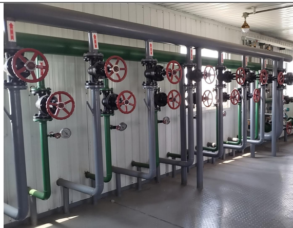
6 号计量间内部
