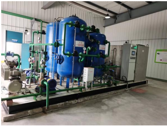
锅炉水处理装置
