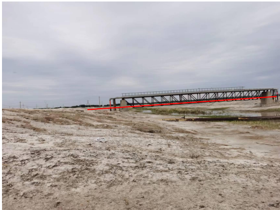
跨渠过桥集油管道
