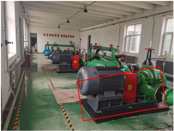
葡三联污水处理站机泵减震基础
