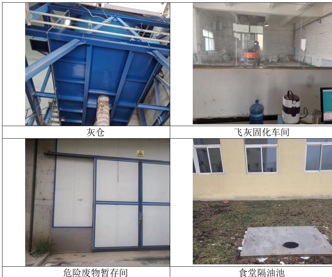
图3.3-8 固体废物处置设施
