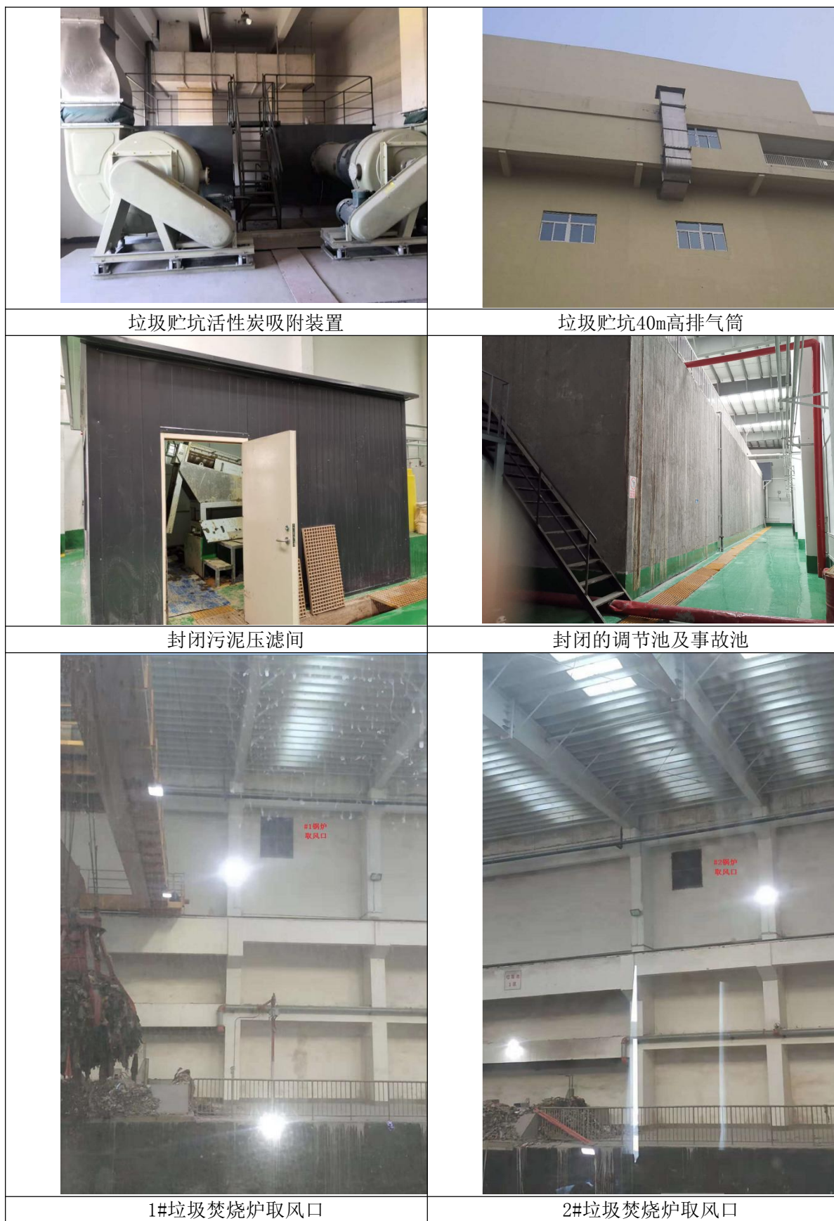
图3. 3-3 恶臭处理设施
