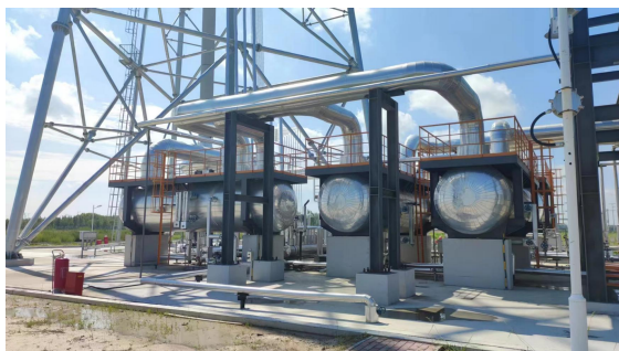
低压分液罐、水封罐
