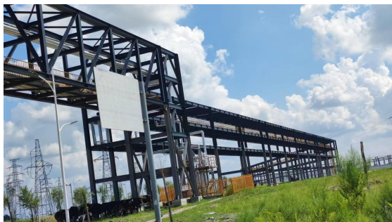
龙江化工与腾运气体段管线
