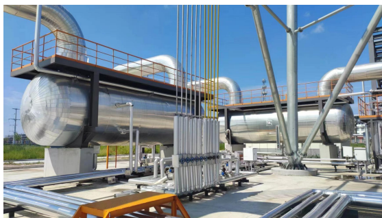
高压分液罐、水封罐
