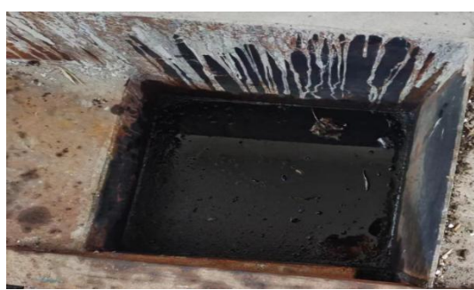
废机油贮存间收集池
