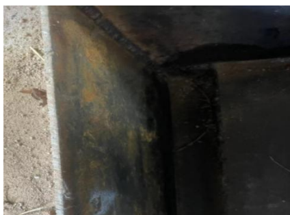
废电池贮存间导流沟
