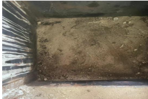
废电池贮存间收集池
